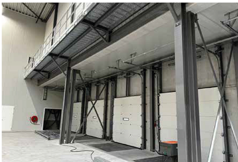
De totale staalconstructie werd voorzien van een brandwerende coating en afgewerkt in de gewenste RAL-kleur.
